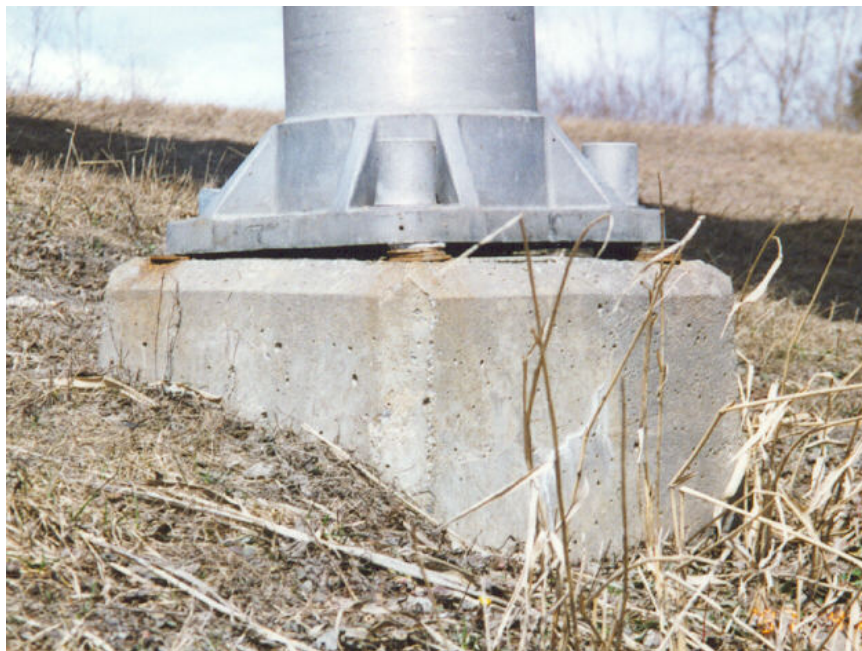
Photographie 5.4-18 Anomalie des tiges d'ancrage
