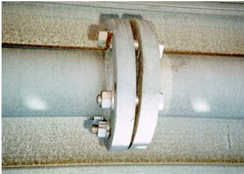
Photographie 5.8-5 Anomalie des assemblages boulonnés
