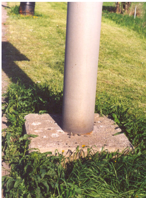
Photographie 5.4-15 Anomalie des tiges d'ancrage
