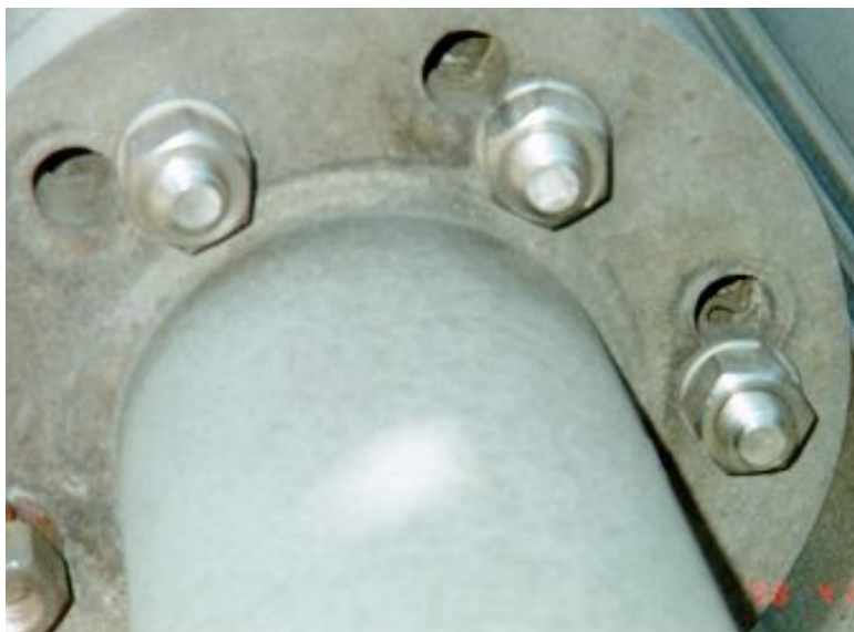
Photographie 5.8-6 Anomalie des assemblages boulonnés
