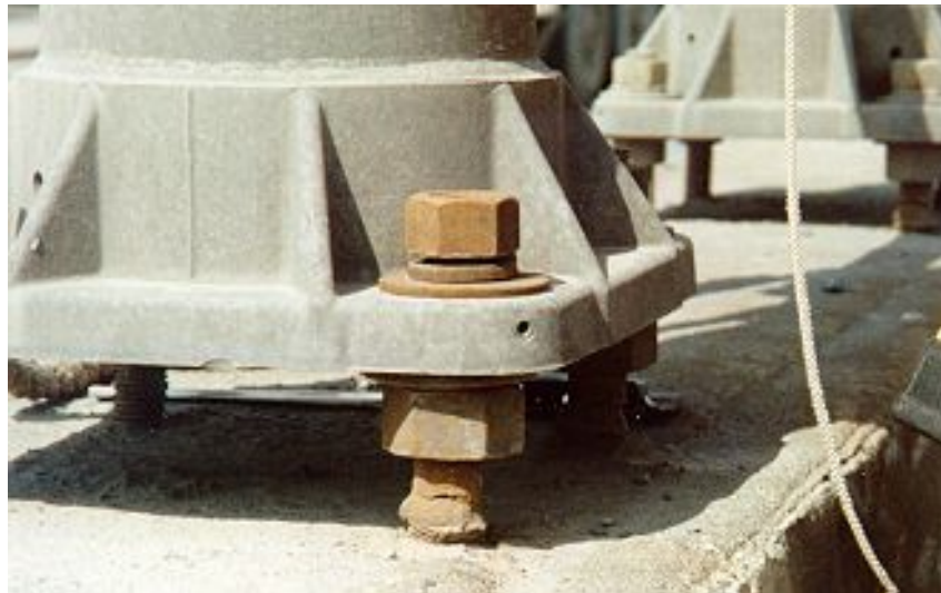
Photographie 5.4-21 Anomalie des tiges d'ancrage
