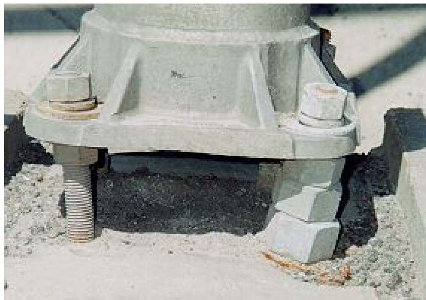
Photographie 5.4-22 Anomalie des tiges d'ancrage
