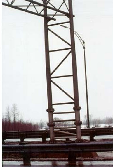
Photographie 5.5-10 Anomalie du support vertical
