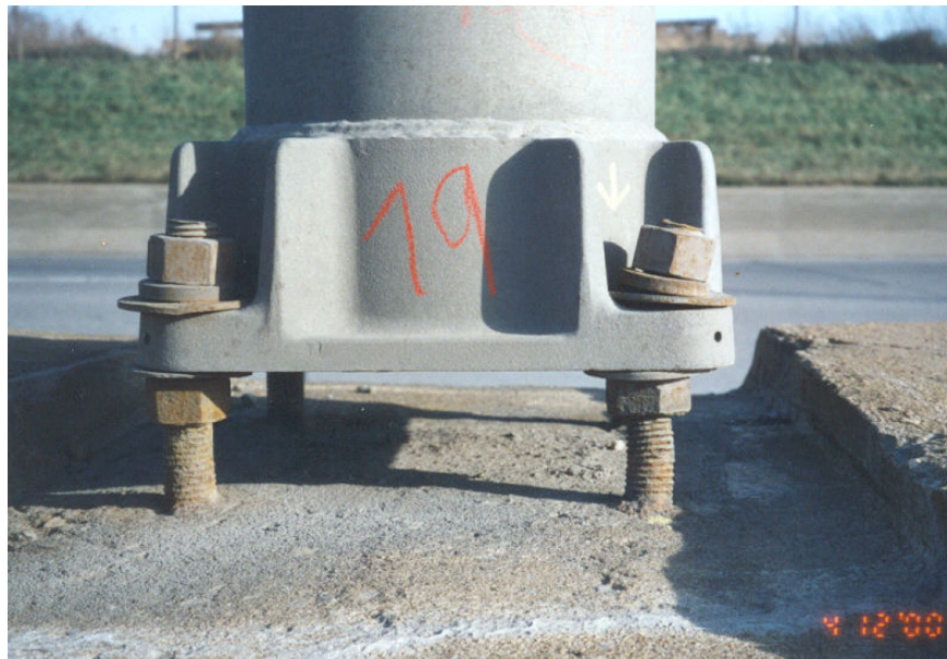
Photographie 5.4-17 Anomalie des tiges d'ancrage
