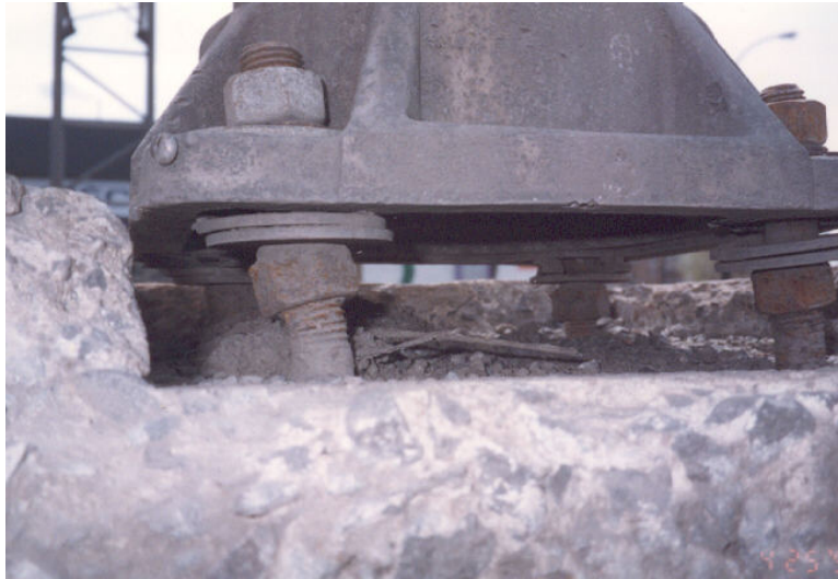
Photographie 5.4-16 Anomalie des tiges d'ancrage
