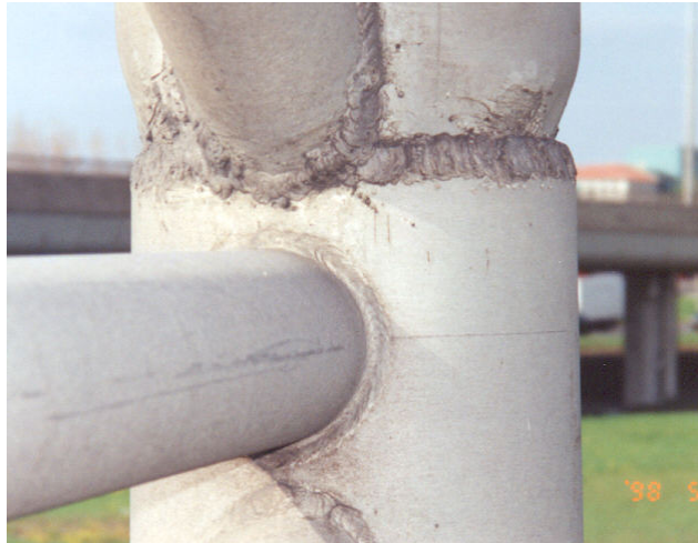
Photographie 5.5-9 Anomalie d'un poteau du support vertical et évaluation du comportement du poteau
