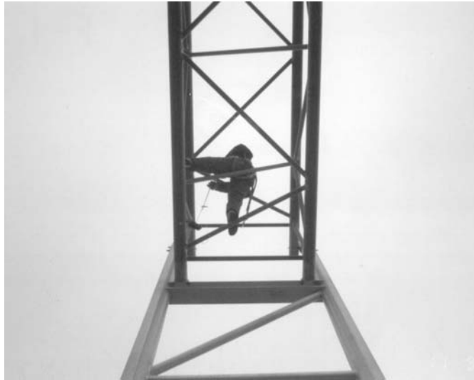
Photographie 5.6-20 Anomalie du support en treillis
