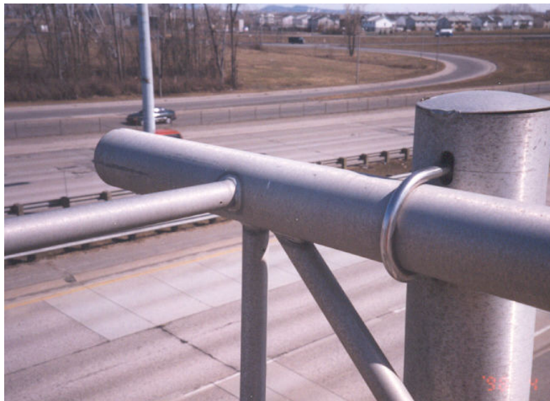
Photographie 5.6-19 Anomalie du support en treillis
