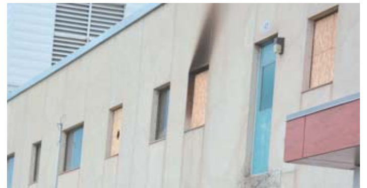
L'incendie, survenu le 20 juin 2015, s'est déclaré dans les locaux du laboratoire au 2e étage de l'hôpital.
