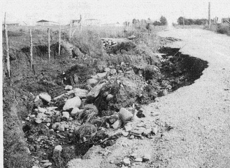
A St-Léon de Standon, cette route secondaire a connu des dommages élevés, et la circulation s'est rendue par le fait même très dangereuse.
