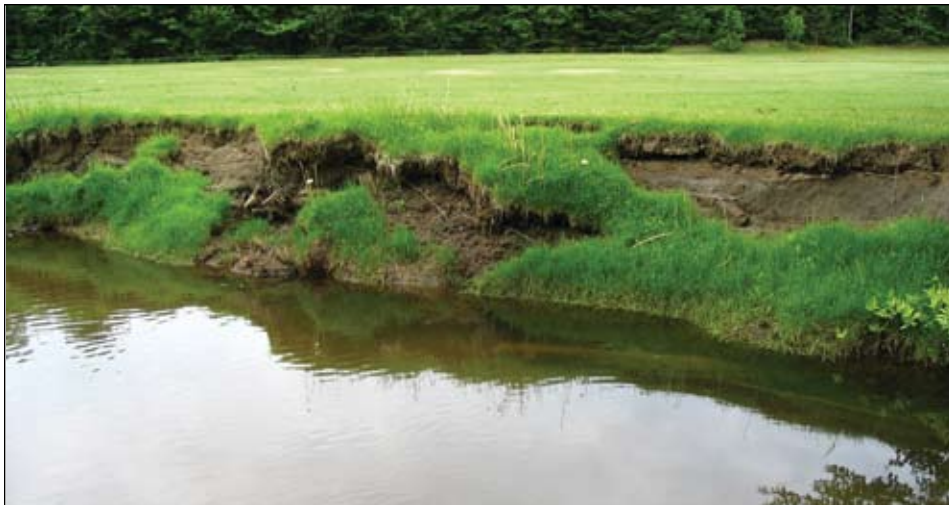
Les racines du gazon ne sont pas assez profondes pour stabiliser la rive. Les arbustes et les arbres sont de meilleurs remparts.
