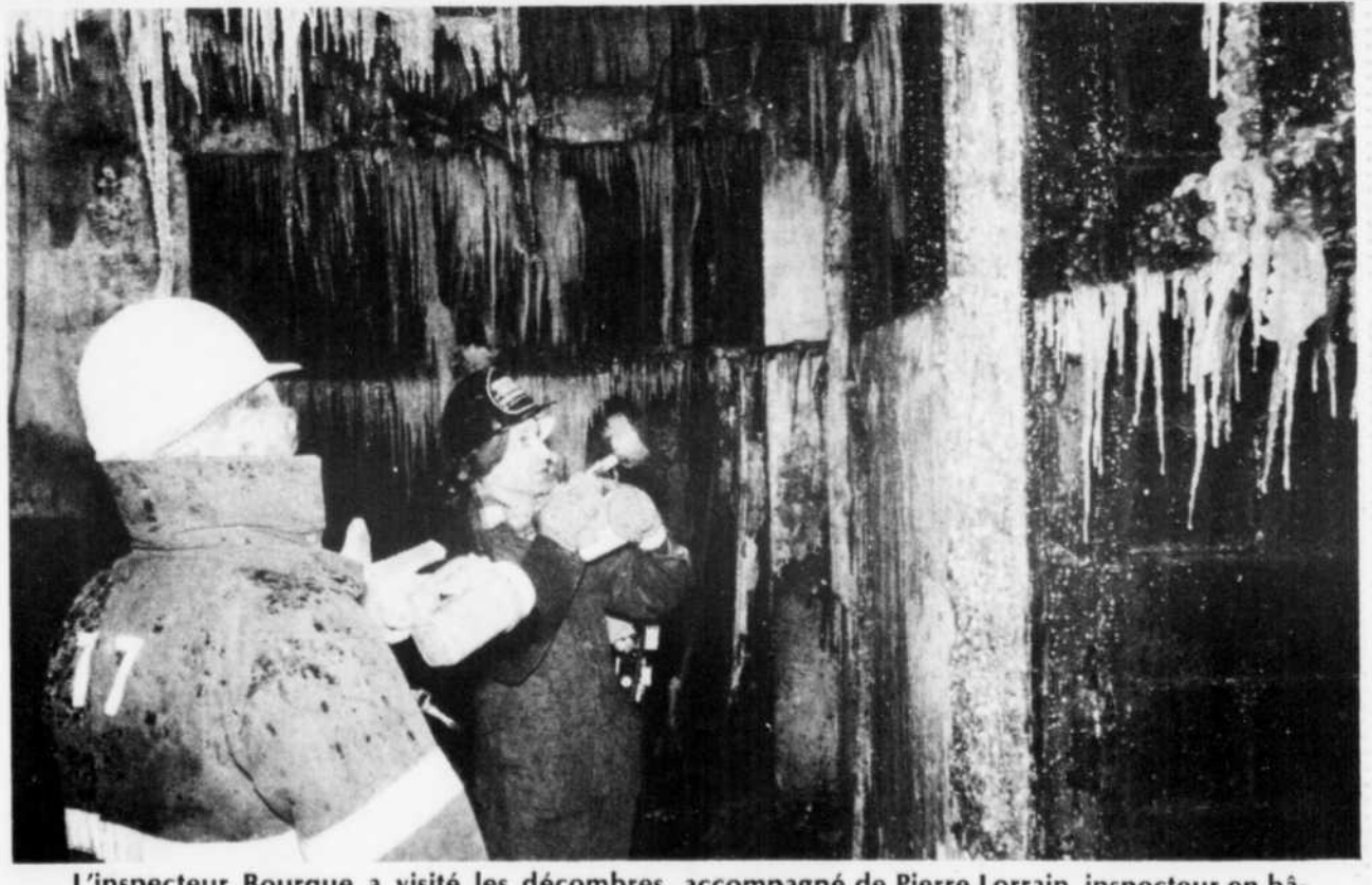
L'inspecteur Bourque a visité les décombres, accompagné de Pierre Lorrain, inspecteur en bâtiments à l'emploi de la ville de Sherbrooke.
