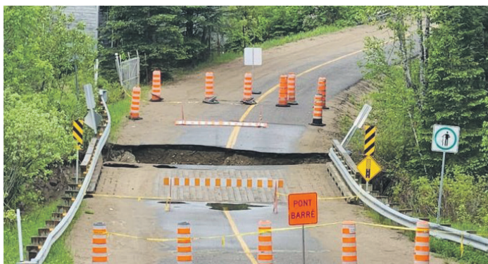
La crue des eaux a endommagé la structure du pont Photo arhive
