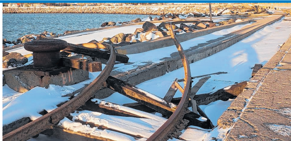
Le rail sur le quai de Chandler a plié sous la force des intempéries. (Photo tirée de Facebook)
