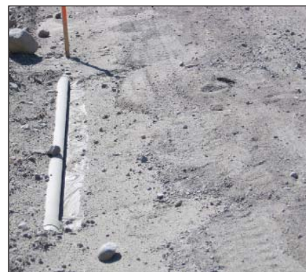
Photo 2 – Systèmes de captation des eaux de ruissellement en bordure de la route forestière
