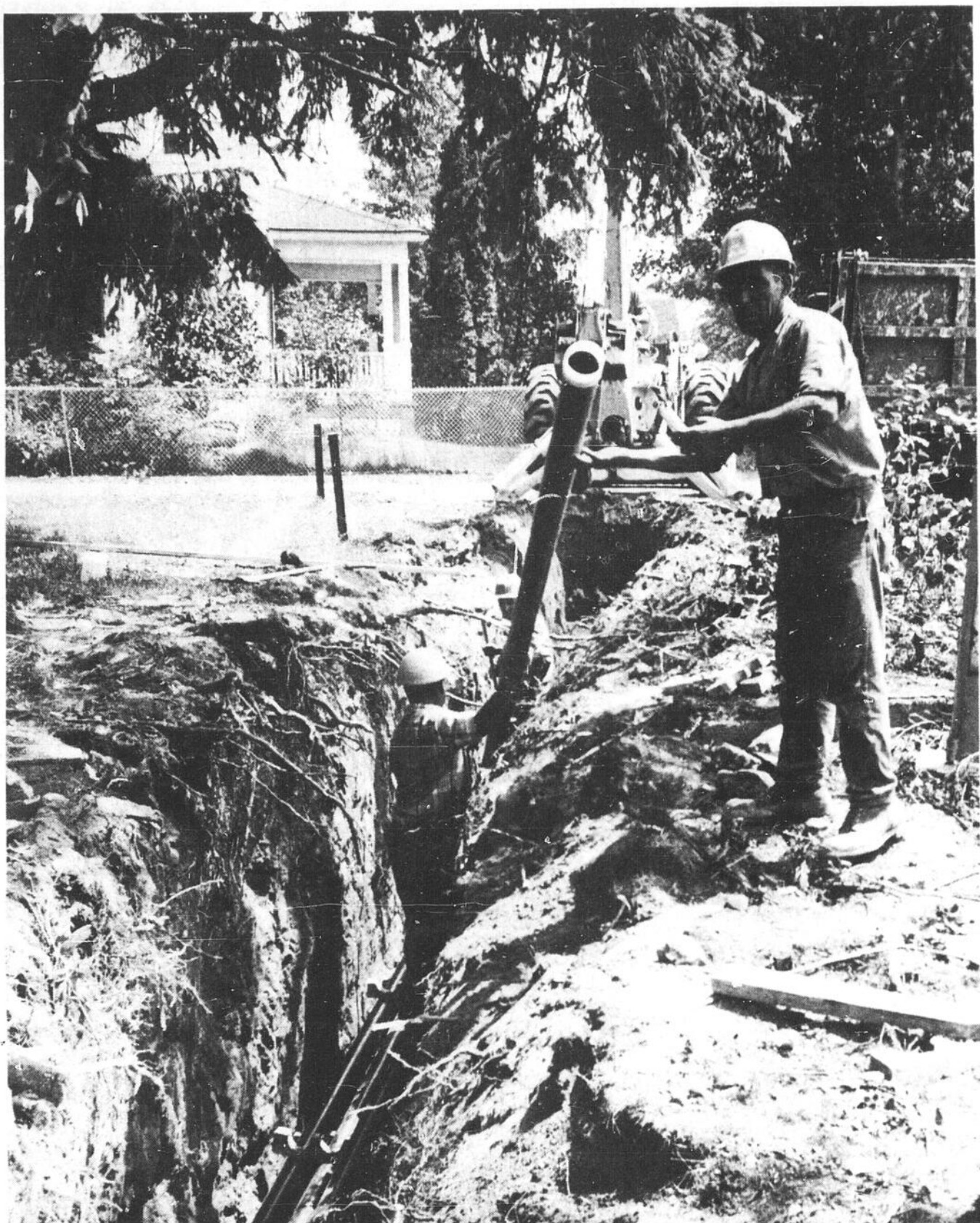
Finis les poteaux, finis les fils aériens. Les câbles téléphoniques passeront désormais à travers ces tubes de plastique, placés sous terre, le long du chemin Merivale, à Ottawa.
